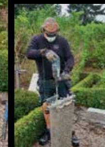
Huller bores i topsten
